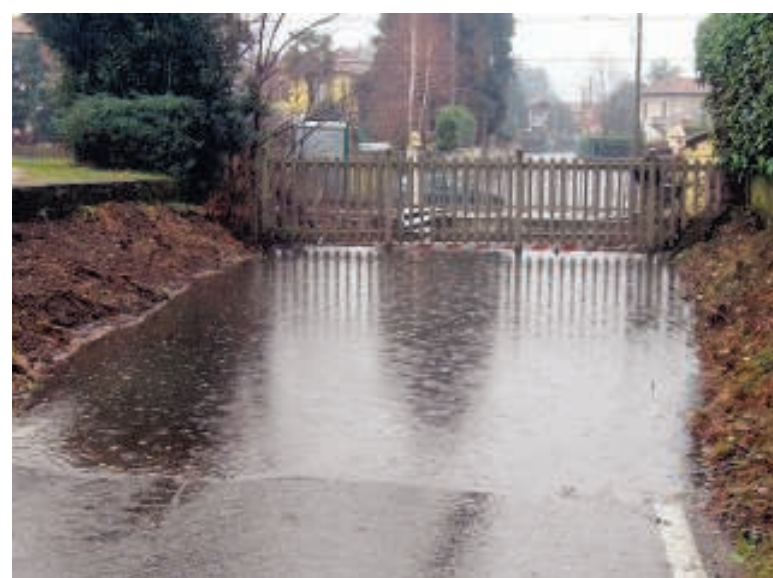
Nella foto in evidenza la gigantesca pozza d'acqua che si è formata al fondo di via Oldrina, in corrispondenza del muro che divide la strada dalla ferrovia
